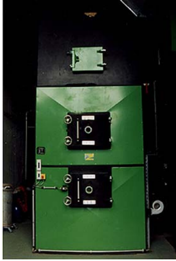
Wohlige Wärme für bereits 167 Wohnungen in Gurk. Und er kann noch mehr!
